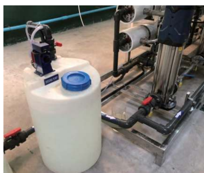
纯水系统 RO System
