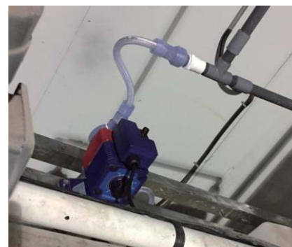
污水处理 Sewage Treatment
