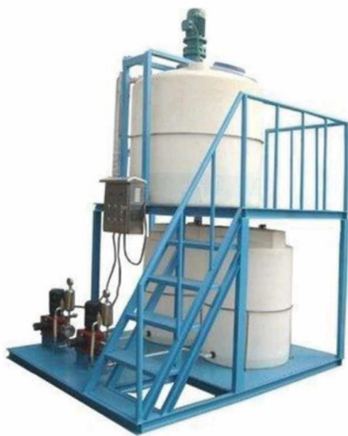
Dosador flocculante FLOCCULANT DOSING FIELD
