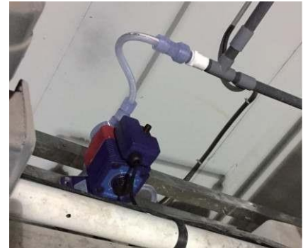
Tratamento de Esgoto
